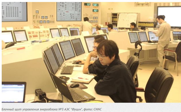
Блочный щит управления энергоблока №3 АЭС «Фуцин», фото: CNNC
