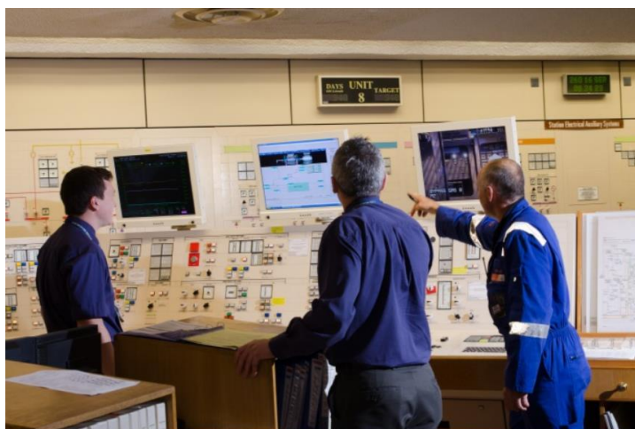
Пользователи системы управления на энергоблоке №2 АЭС «Хейшэм В», фото: EDF Energy
